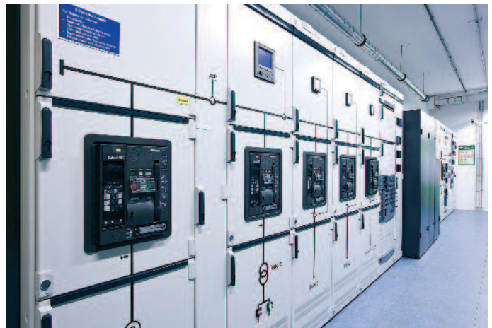
Blick in das Rechenzentrum
