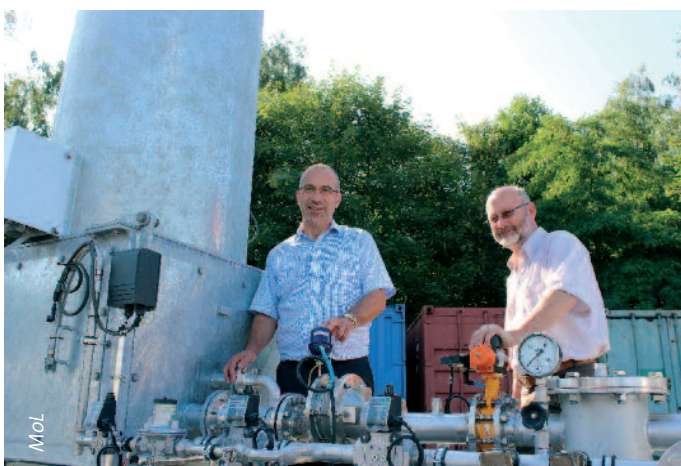
Prokurist Jürgen Siewerth (l.) und Geschäftsführer Gernot Eberhard vor einer von Palatina GeoCon selbst entworfenen, mobilen Testanlage für die Trennung des Erdöls in Rohöl, Wasser und Gas bei der Betriebsstätte vor Ort.
