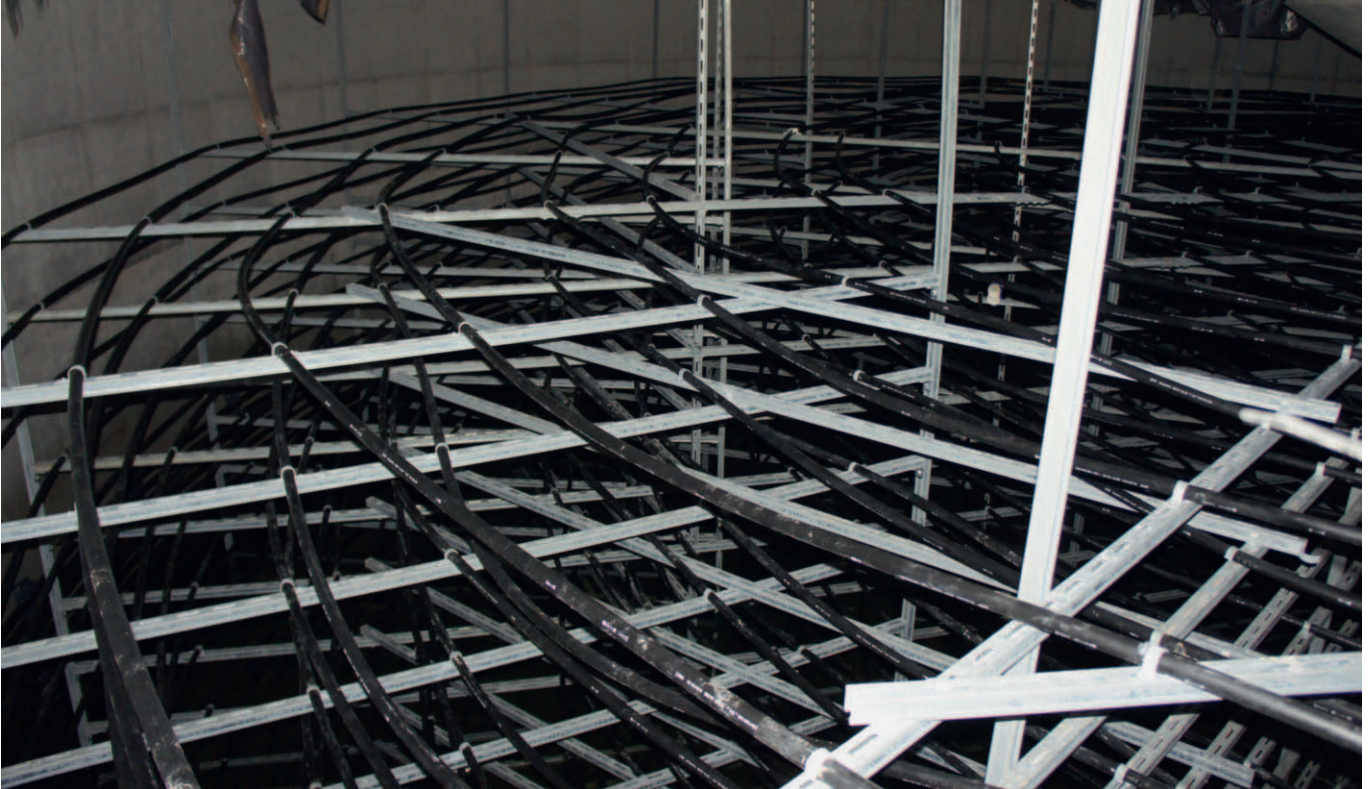
Eisspeicher von innen: Die spiralförmig angeordneten Wärmetauscher nehmen die Energie auf, die bei der Abkühlung und Kristallisation des Wassers entsteht.
