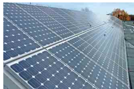
Nützlich: Die Solaranlage hat 950 qm reiner Solarmodulfläche.
