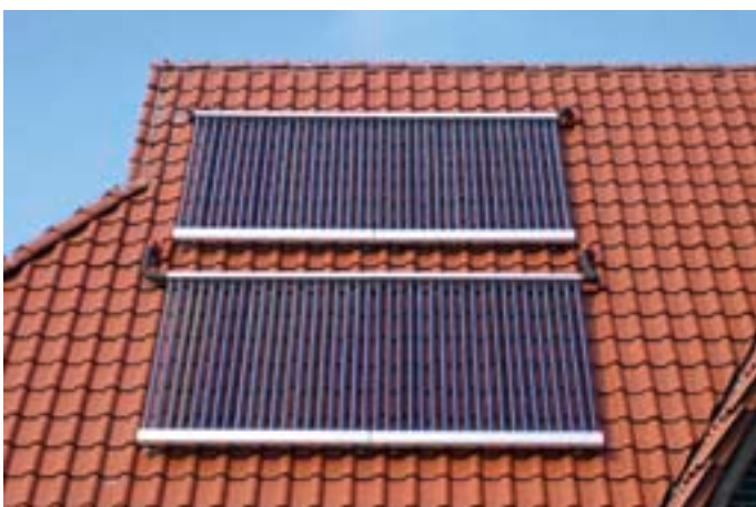
Vakuumröhrenkollektoren s-power 20/2000 TPS inside: Hier wurden sie auf das Dach eines Wohnhauses montiert.
