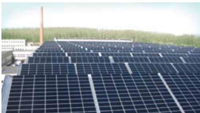
Nennleistung: 993,825 kWp, Standort: Oschersleben.
