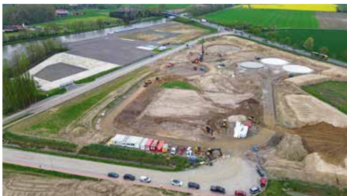
Die Arbeiten am Hafen Wittlager Land (HWL) schreiten voran. Der Betrieb soll im 2. Halbjahr 2024 beginnen.
